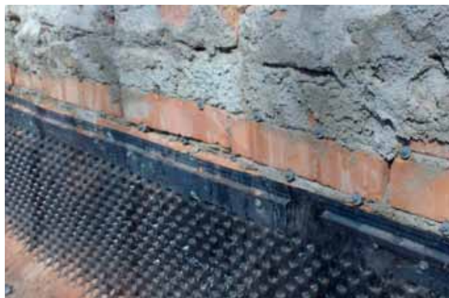
Po chemické injektáži nad úrovní vlhkého zdiva je žádoucí spodní stavbu ochránit nopovou fólií. Grading
